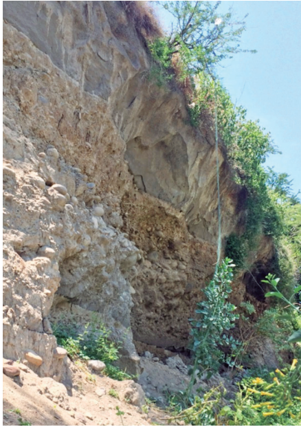
Imagen 8. Zona de derrumbes en muro sureste
